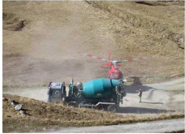
Betonmischer auf dem Oberalppass. Der Beton wird in Kübeln in die Hintere Felli geflogen
