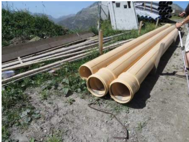
Rohrleitungen und Eisenträger
