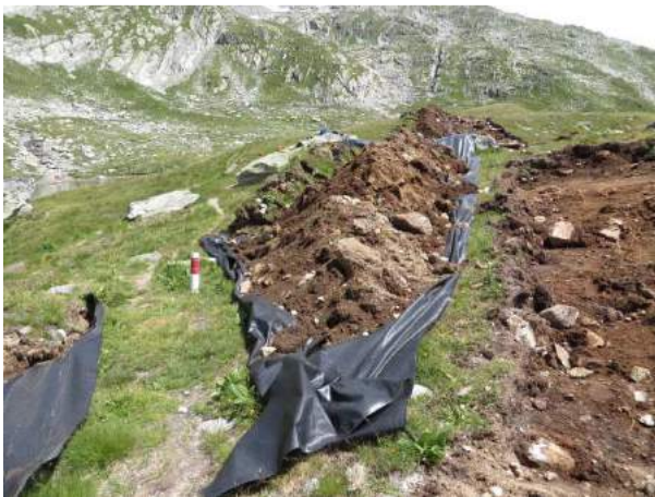
Wasserleitung vom Lutersee gegen den Schneehüenerstock
