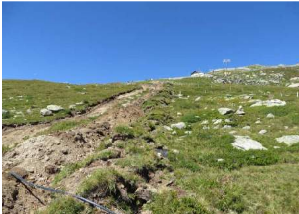
Leitung für die Beschneigungsanlagen Unterstafel – Gütsch (25.08.2016)
